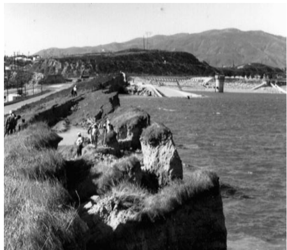
Figura 41 – La presa San Fernando fue afectada gravemente por el Terremoto de San Fernando en 1971.
