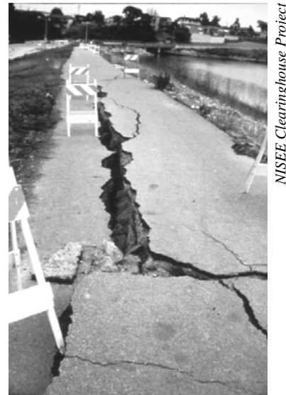
Figura 39 – Expansión Lateral. Terremoto de Loma Prieta, Octubre 17, 1989. La expansión lateral dañó el nivel de la carretera a lo largo del Río San Lorenzo.
